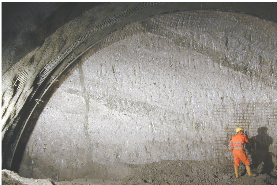
Abb. 4: Störungen und Spalten in den verkitteten Deltasedimenten des Vomperbaches, Foto bei TM 20,6 im Vortrieb Vomp Ost.
