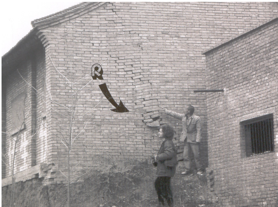
Abb. 2: Subsidenzerscheinungen im Löss durch intensive landwirtschaftliche Bewässerung und Niederschläge sind eines der Hauptprobleme der Bevölkerung; Risse im Mauerwerk der Häuser (R) von Wen Tia Po nahe Lantian durch Setzungen im Löss (Foto: J. Weidinger, 1997).
