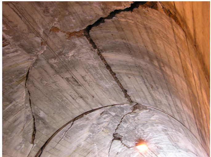
Fig. 1: Seit 1995 ereigneten sich jährlich Block- und Felsstürze. Durch die Entfestigung der Felsrippe wurde das Tunnelgewölbe stark zerrissen
