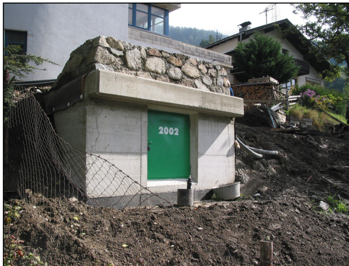
Abb. 15) Brunnenstube für Quellwassernutzung
