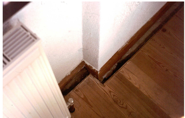
Verschobene Hausmauern, Restaurant Steinegg
