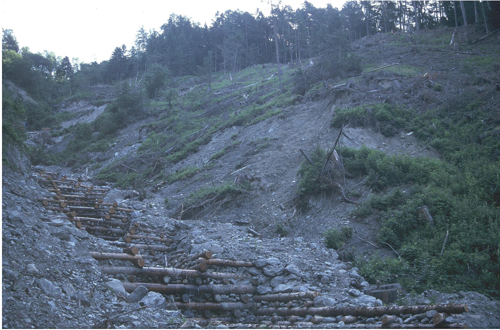
Bild 8: Patsch – Dorfbachl – schwere Tiefen – und Seitenerosionen mit Hangentlastung und Holzstaffelung (WLV)
