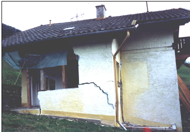
Abb. 2: Rissbildungen am Haus Hörtnagl, 1994
